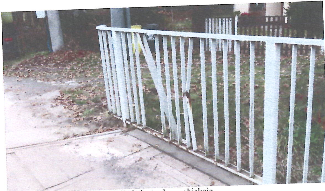
Fot. 3. Lokalne uszkodzenia szczelin balustrady na obiekcie
