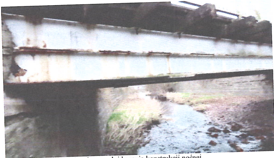
Fot. 7. Uszkodzenia powłok ochronnych i korozja konstrukcji nośnej
