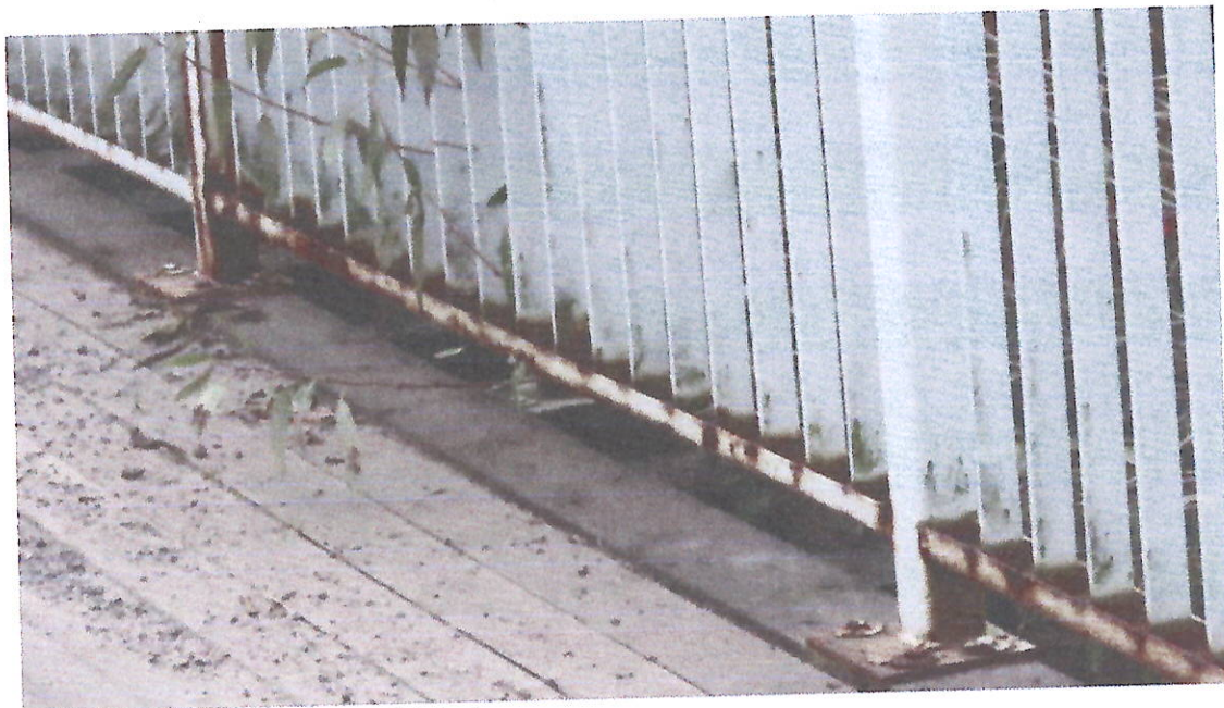
Fot. 2. Korozja balustrady na obiekcie
