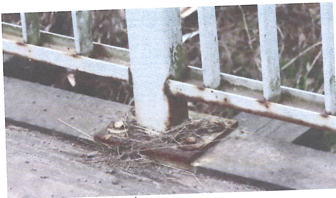
Fot. 4. Korozja stopki słupka balustrady
