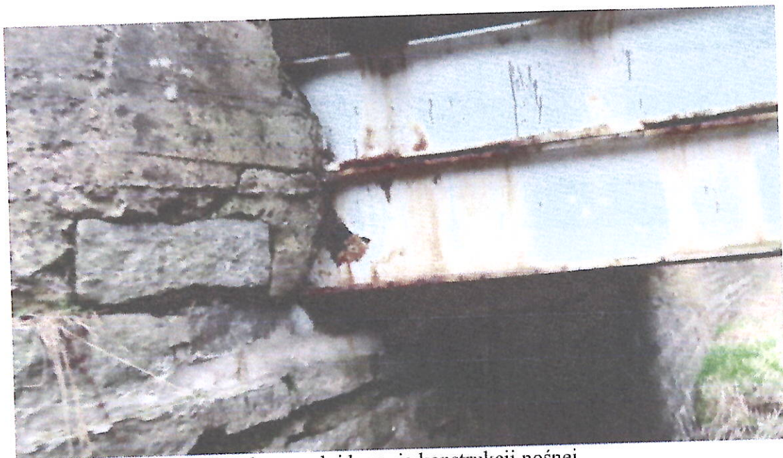
Fot. 8. Uszkodzenia powłok ochronnych i korozja konstrukcji nośnej
