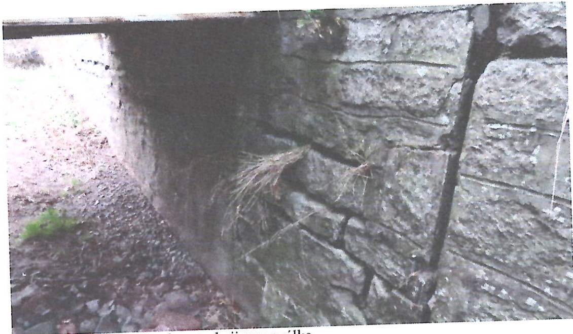
Fot. 11. Wykruszone spoiny konstrukcji przyczółka
