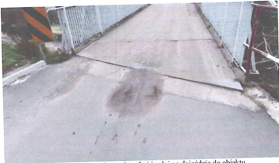
Fot. 1. Zanieczyszczenia i deformacje nawierzchni jezdni na dojeździe do obiektu
