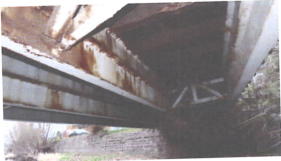
Fot. 9. Korozja konstrukcji nośnej
