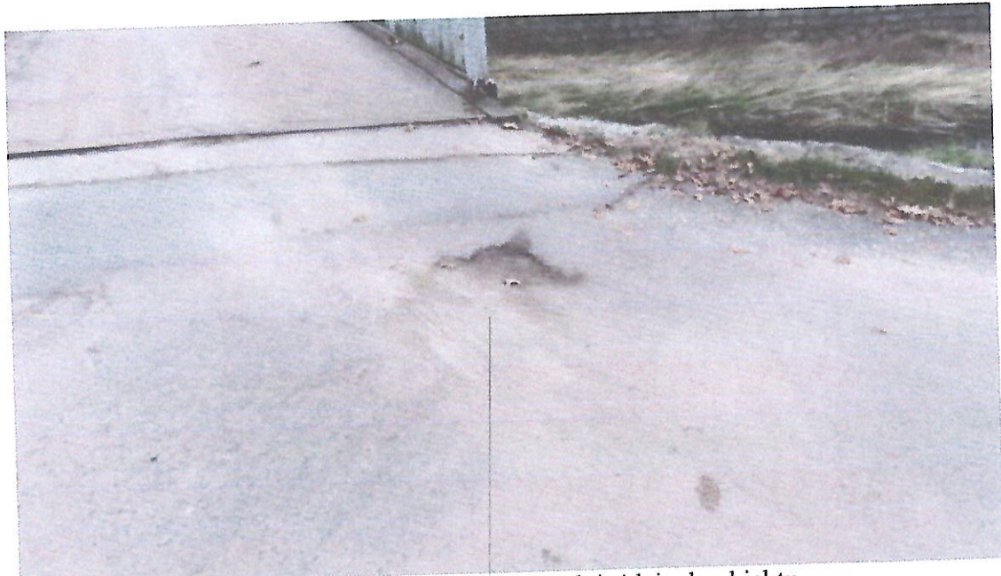
Fot. 5. Lokalne uszkodzenia w nawierzchni jezdni na dojeździe do obiektu
