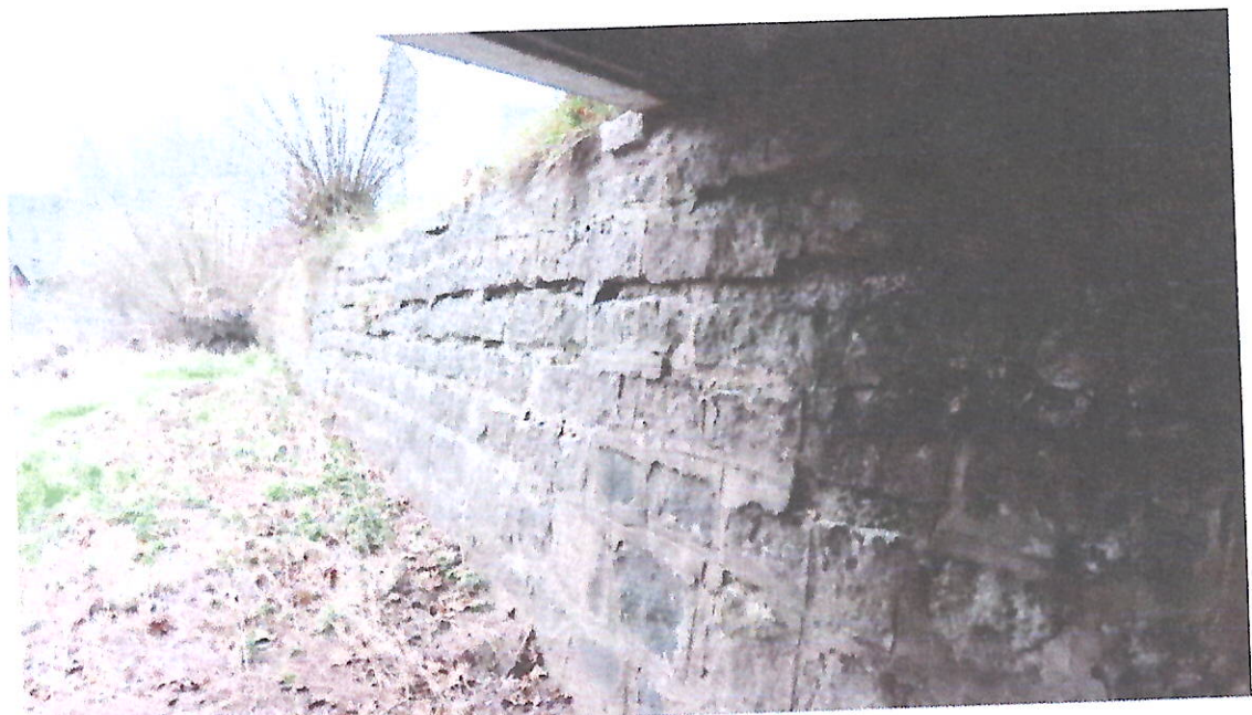
Fot. 12. Lokalne uszkodzenia powierzchni przyczółka
