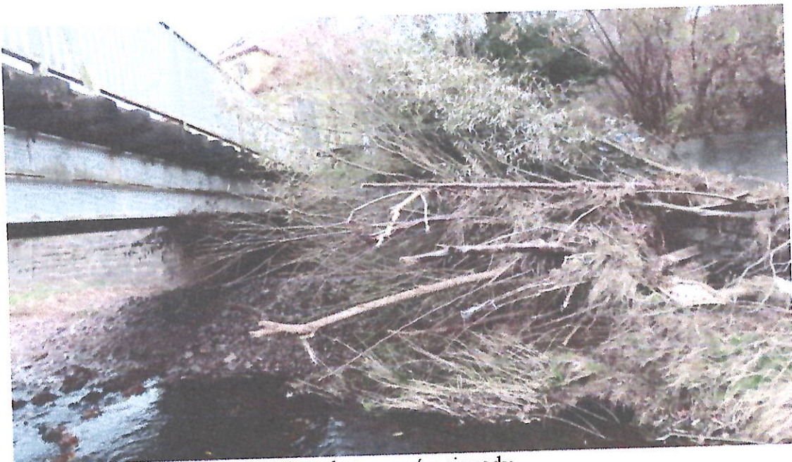
Fot. 6. Zanieczyszczenia koryta ciekłu od strony górnej wody
